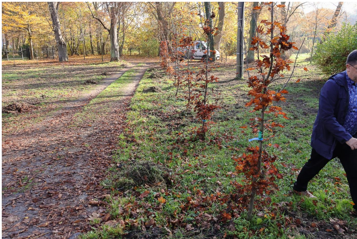
Fot. 43 Rewitalizacja terenu zieleni w parku zabytkowym w m. Soczewka gm. Nowy Duninó
